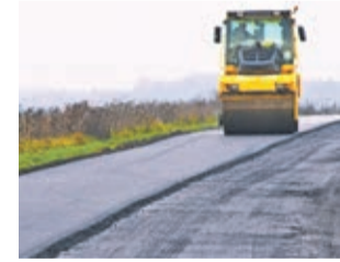
Jedna z ważniejszych inwestycji w toku - za gminne pieniądze oraz pozyskane z rządowych funduszy - trwa remont drogi od Naroczyc przez Górzyn do Olszan
