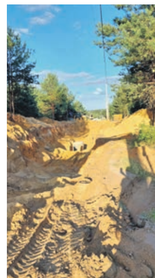
Jeszcze kilka miesięcy temu wielkie wykopy- dzisiaj wybudowany wodociąg dostarcza wodę do nowego osiedla pod Grzybową Górą w Koźlicach
